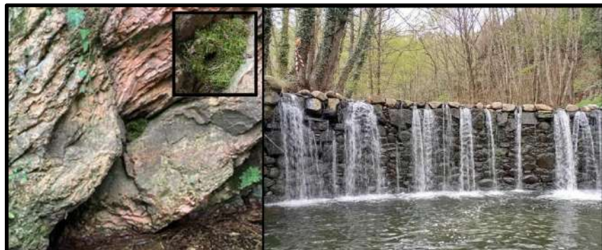
Figura A.4.13. Resclosa de la Casa de Colònies (Font: pròpia).
