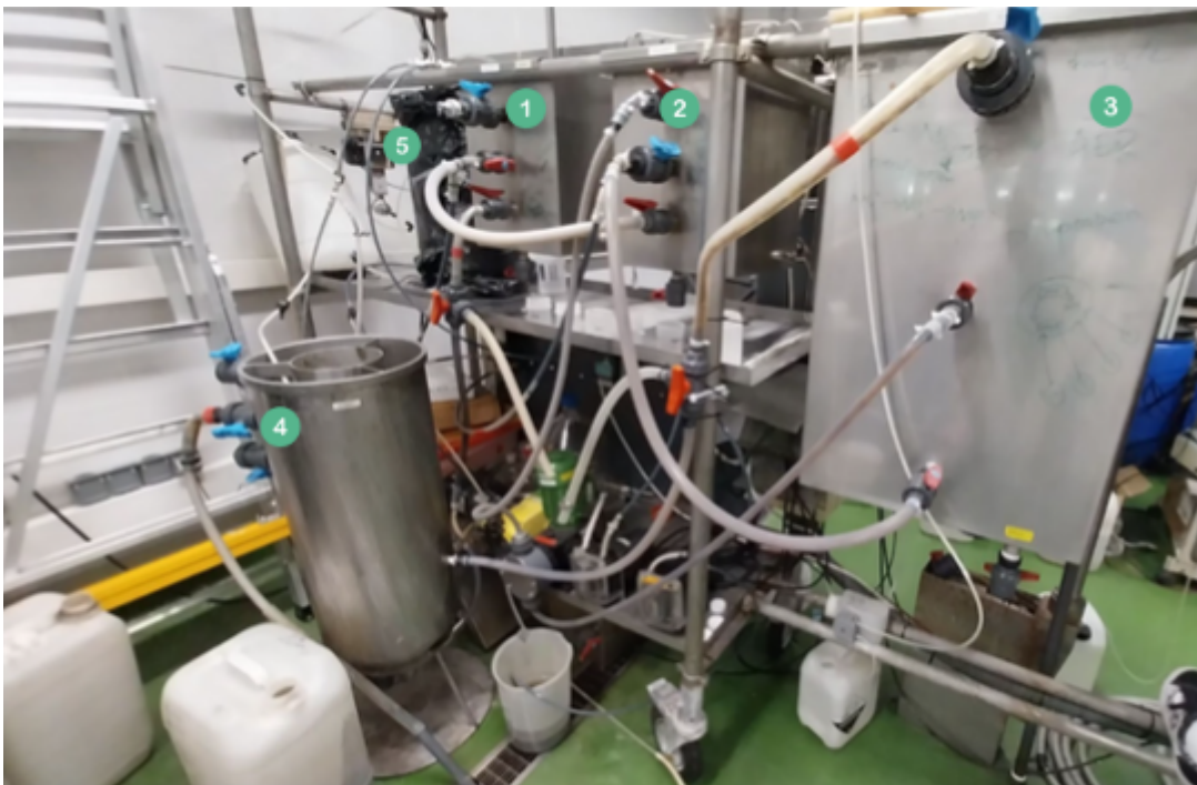
Imatge 11: Fotografia de la planta depuradora de la UAB. Cada tanc està numerat seguint l'esquema de la imatge 10. Font: pròpia
