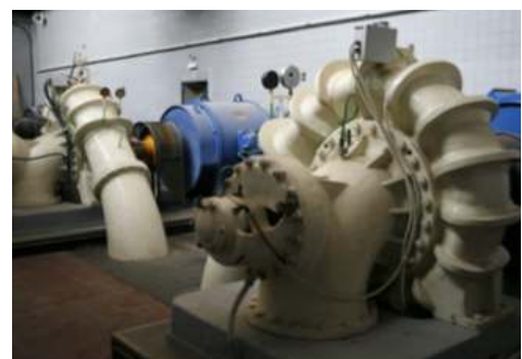
Figura 15: Estació de bombament.
